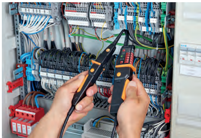
Měření napětí v rozvodné skříni.
