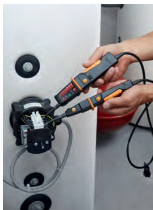
Měření napětí na kotli.
