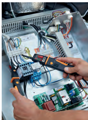
Měření napětí na kompresoru.
